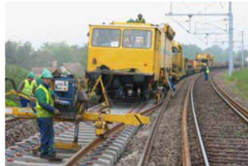
Longs rails soudés sur traverses béton
