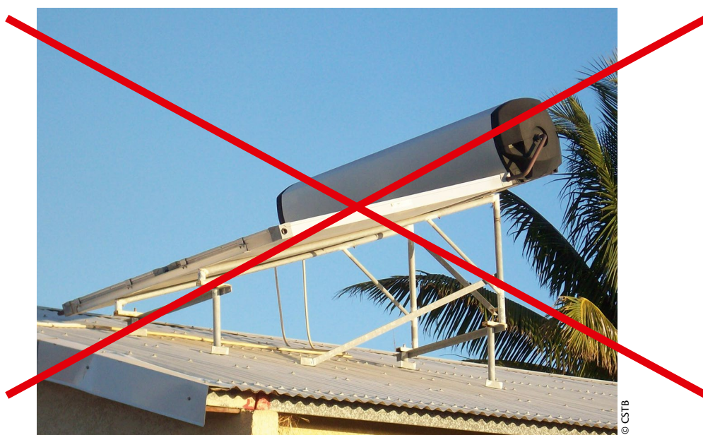
Figure 159 : Exemple à éviter d'installation non parallèle à la toiture et avec système d'ancrage « fait maison »
