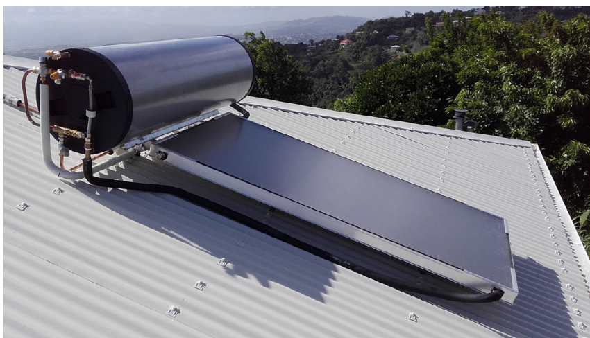
Figure 157 : CESI à thermosiphon sur toiture tôle
